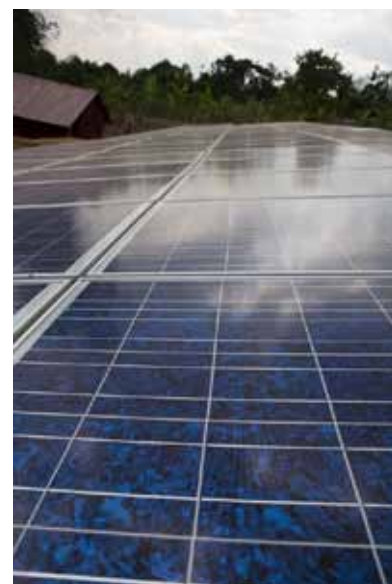
Solpanelsparken som driver vattenanläggningen är Ugandas största.
